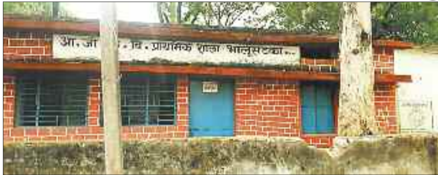
जर्जर भालूसटका का प्राथमिक शाला भवन।
